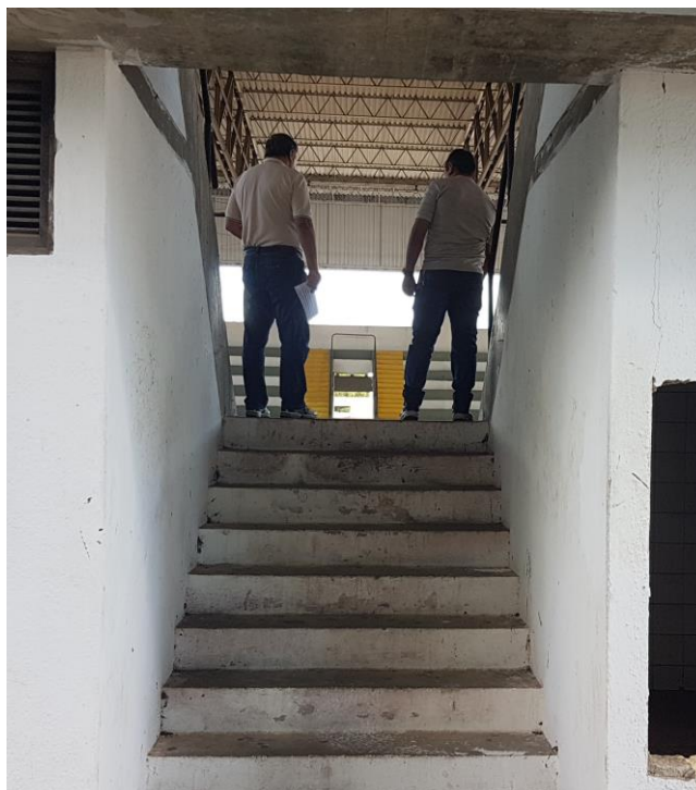
Imagem 03 – Foto tirada in loco da escada no andar superior sem corrimão. Fonte: COPROJ-SEINF.
