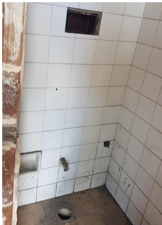
Imagem 14 – Foto tirada in loco em um dos banheiros. Fonte: COPROJ-SEINF.
