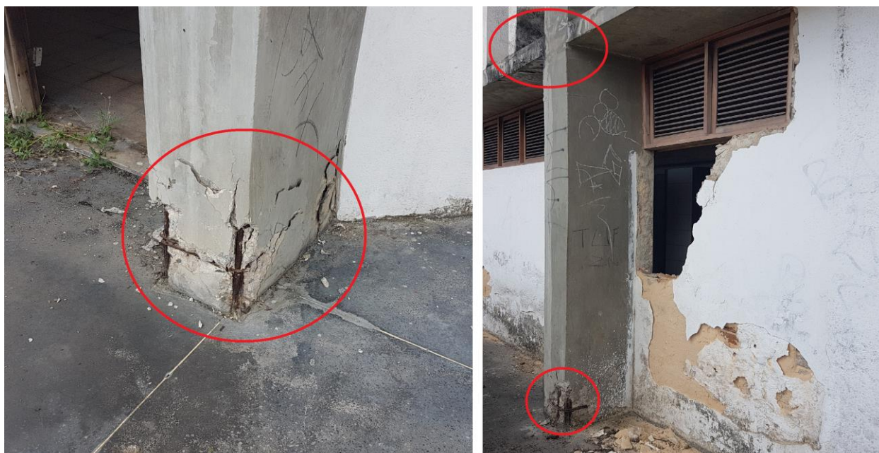
Figura 2 – Foto tirada in loco da situação de corrosão e infiltração do pilar. Fonte: COPROJ-SEINF.
