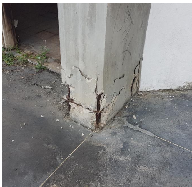
Imagem 26 – Imagem dos pilares de concreto que necessitam de reforço/reparo. Fonte: COPROJ-SEINF.
