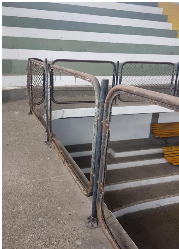
Imagem 06 – Foto tirada in loco do guarda-corpo danificado na arquibancada superior. Fonte: COPROJ-SEINF.
